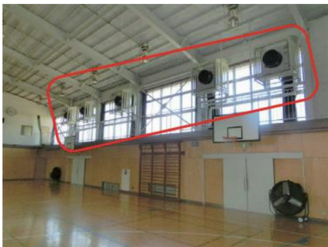
清瀬小学校体育館空調
