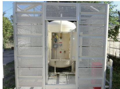
清瀬中学校LPガスタンク
